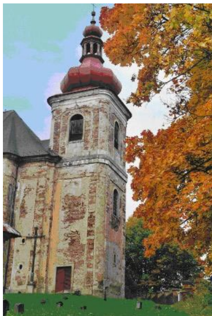
většina kostelů je ve špatném sta- vu jako tento v Heřmánkovících
